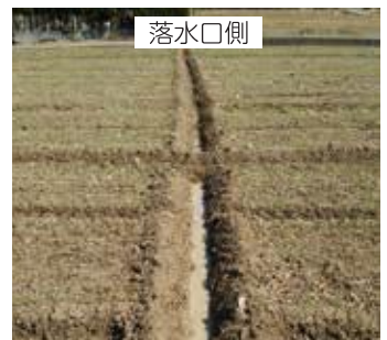
連結不足による滞水
